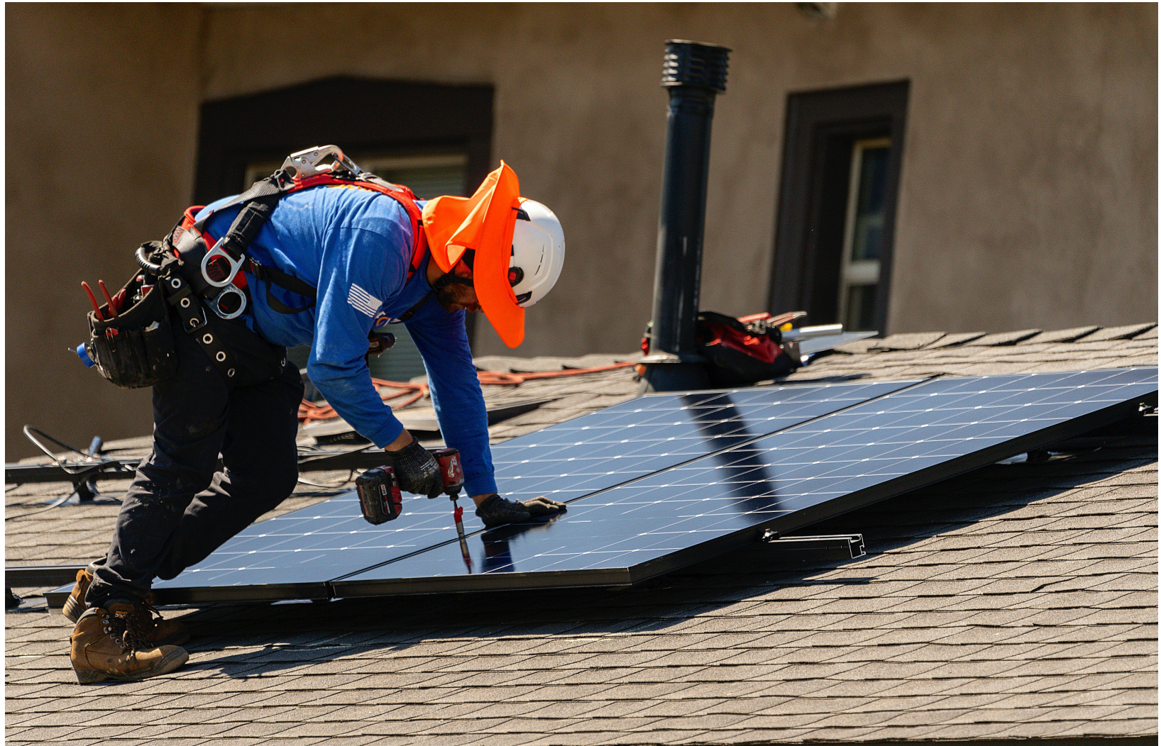
Les séances d'information donnent des conseils sur l'installation de panneaux solaires chez soi. Keystone
